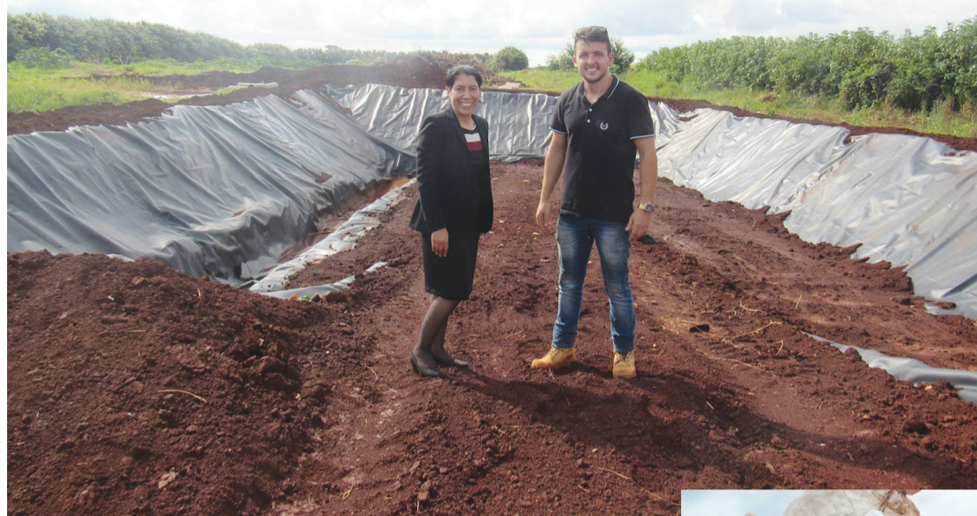
A prefeita Suely acompanhando a construção da nova trincheira no aterro sanitário
