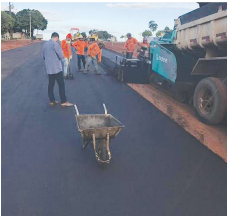
Pavimentação asfáltica foram executadas em Moreira Sales, Paraná do Oeste e na Vila Gianelo
